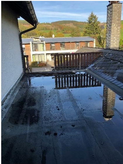
Absturzgefahr fehlendes Geländer
